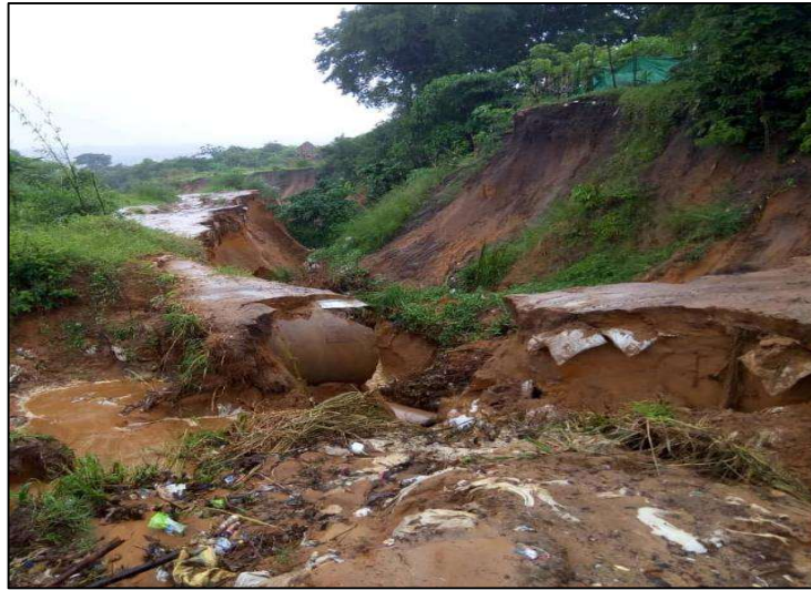
Photo 1. Ravinement dans la route Nzolana-Kinshasa vers la forêt Ndangi
