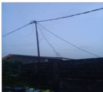
Photo 7. Un poteau de courant dans l'avenue Bikoro
