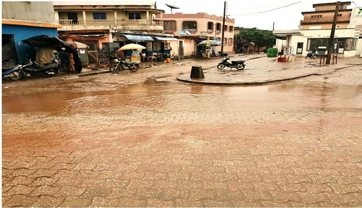
Photo 1: Eaux stagnées sur la voie pavée
