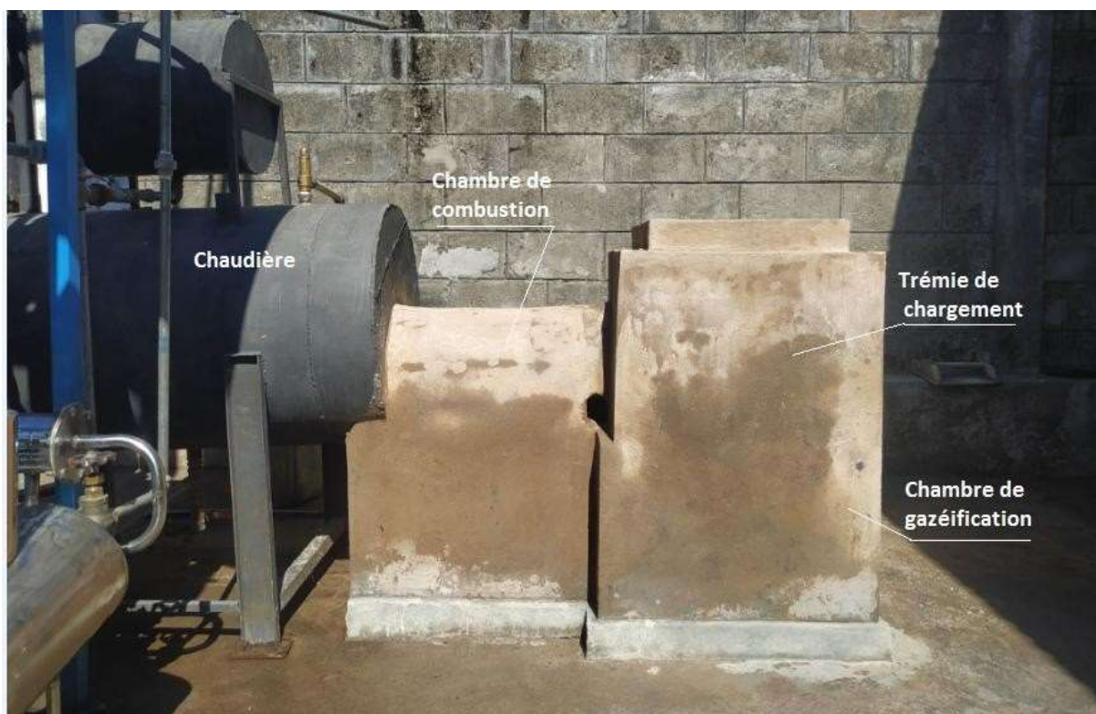
Figure 5: Phot de la chaudière et du foyer de combustion
