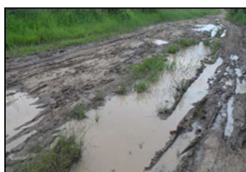
Planche 1 : Vues partielles de la dégradation des pistes en terre de la Commune d'Athiémé en saison pluvieuse
