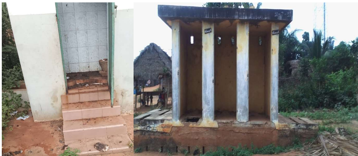
Figure 1 : Latrine remplie d'ordures voire en état dégradé
