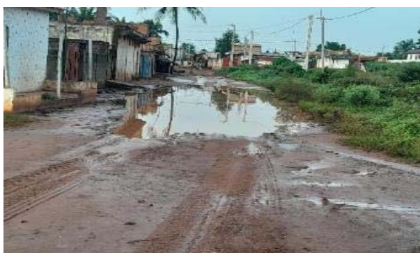
Photo 1 : Route dégradée et inondée à Tanmè
