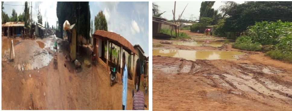
Planche 3: Dégradation de la voie principale de sogan/akossavié(3.1)et de hounsévié(3.2) Prise de vue :Djossou, novembre 2020
