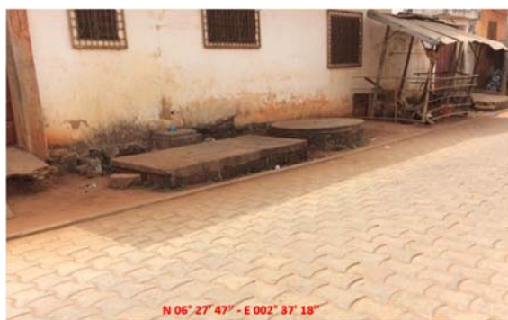
Photo 1 : Puisard installé aux abords de la voie à Gbècon
