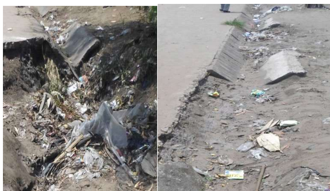
Photo 1. Caniveaux détruits par l'érosion hydrique le long du Boulevard Lumumba à Mikonga I
