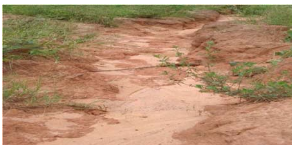
Photo 1: Parcelle fortement érodée dans l'arrondissement de Odougba
