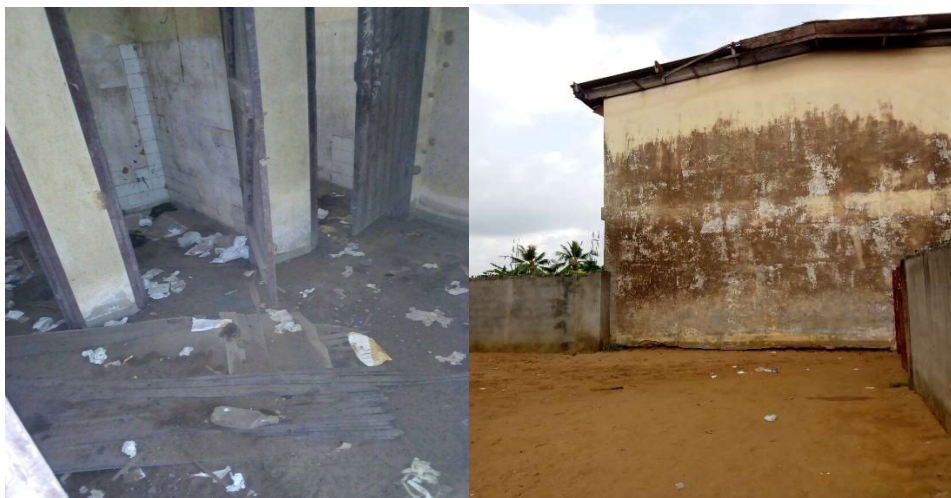
Photo 6 et 7 : Etat de dégradation de l'environnement physique des écoles
